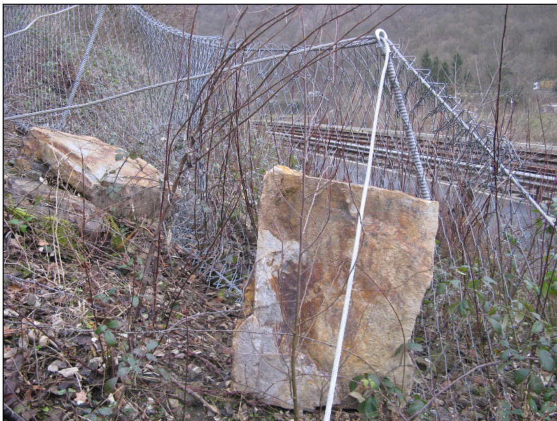
Abb. 1: Beispiel eines belasteten Ösenankerzauns oberhalb einer Straße (Foto: Dr. J. Matthesius)
